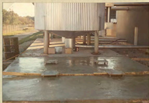
Gjutning av betongplattan och in- justering av plattorna för reaktor- tankens ben. 75.10.21.
