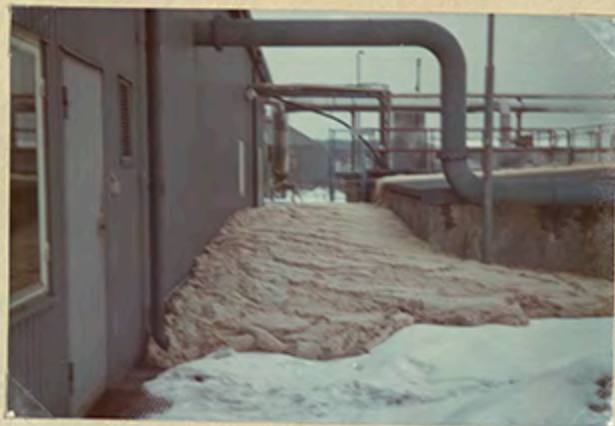
Luftningsbassängerna skummar över.
