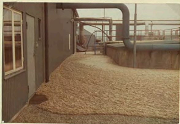
Luftningsbassängerna skummar över.
