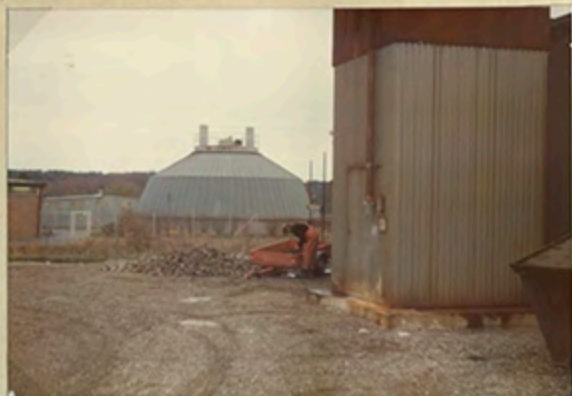
Sortering och tvättning av natursten. (runda med storlek 80 - 120 ) till sten- bädd i reaktortank. 75.10.29.
