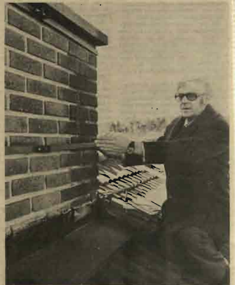
Skorstensfejarmästare Ake Larsson vid en av de fuktskadade skorstenarna: — Fukten tränger så småningom genom röckkanalen och ända ned i pannrummet, säger han.
