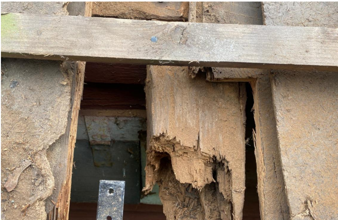
Fig. 14. Borttaget skadat undertaksmaterial. Rötskadad sparre frilagd.
