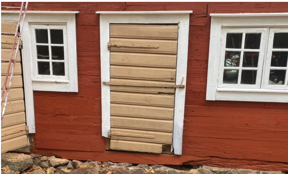
Fig. 11. Skarvad syll. Notera de tre blixtskarvarna, av vilka den mittre kom att täckas av dörrrens sparklist. Bålebrädan längst ner, mellan dörrarna, är ny.
