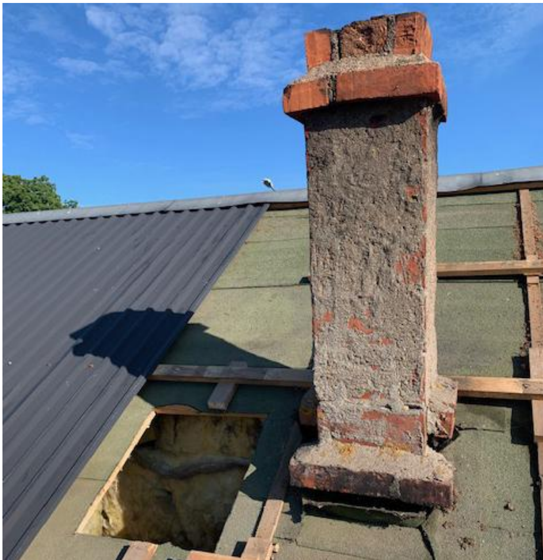
Fig. 27. Skorstenen efter att plåten tagits bort, samt den gamla takpappen. Skorstenen var ej i brukbart skick och togs bort. Hålet i underbrädningen är gjort i samband med att ny rökgång åt eldstaden skulle muras. Foto David Carlsson.
