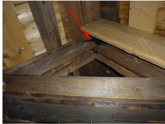
Fig. 19. Brandskada på sparrkryss (pilen).
