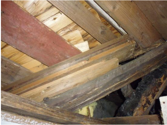
Fig. 18. Brandskada i gradsparre (t.b).
