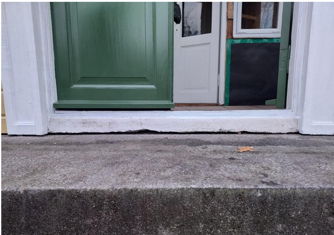
Fig. 9. Vy mot ytterdörrens tröskel. Notera glipan mellan tröskel och vattbräda, som bör täckas med borstlist.
