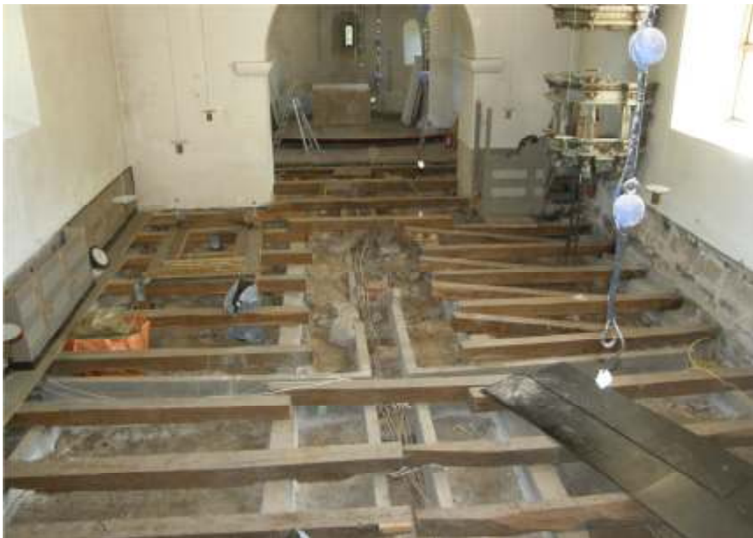
Fig. 6. Vy över långhuset och koret efter borttagning av befintligt trägolv. Notera golvbjälkarnas sentida, gjutna stöd. I mitten gjuten kabelkanal, vilken bilades bort under arbetet.
