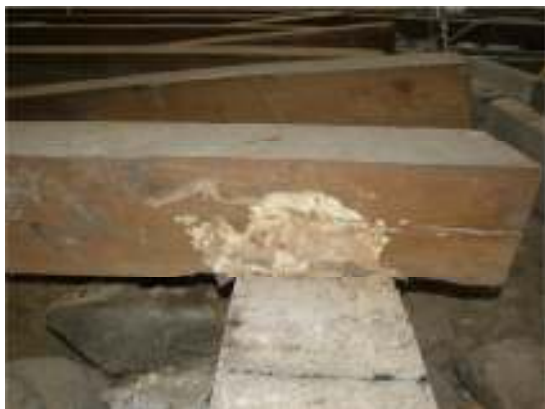
Fig. 3. Svampangrepp på ekbjälke.
