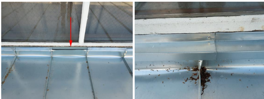
Fig. 10. För kort plåt mot fönsterkarm.
