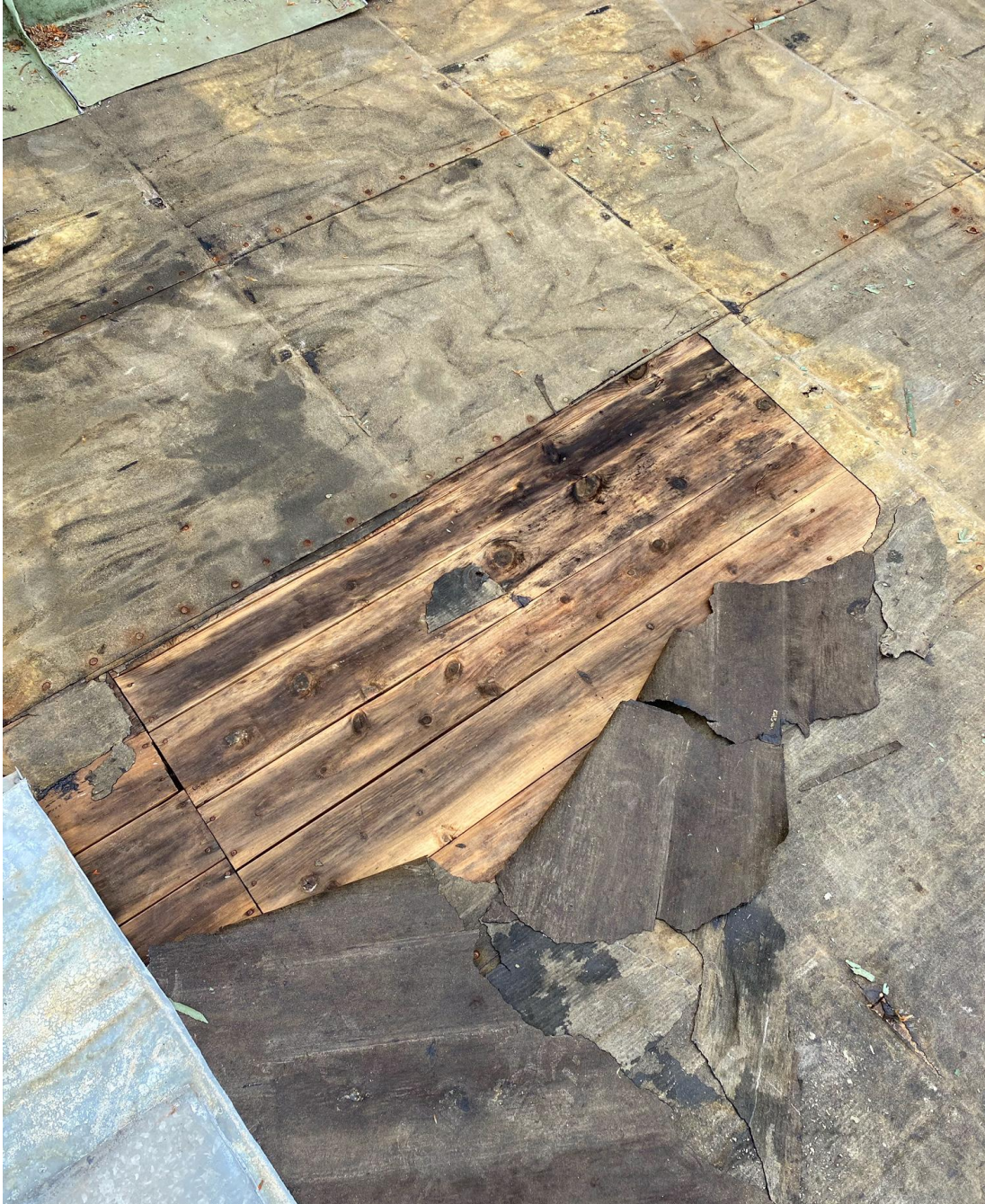
Fig. 12. Rötskadad underbrädning. Foto Anders Hammarling
