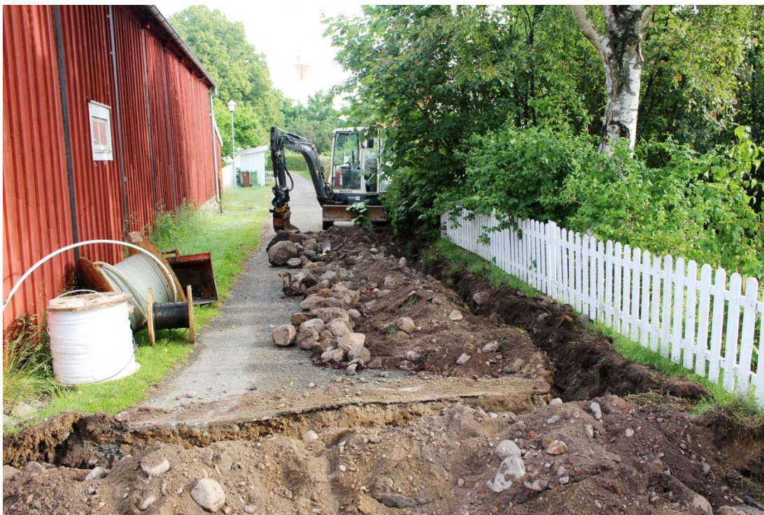
Figur 9 Ställvis framkom rikligt med sten i linjesträckningens schakt. Östra Vallgatan mot N
