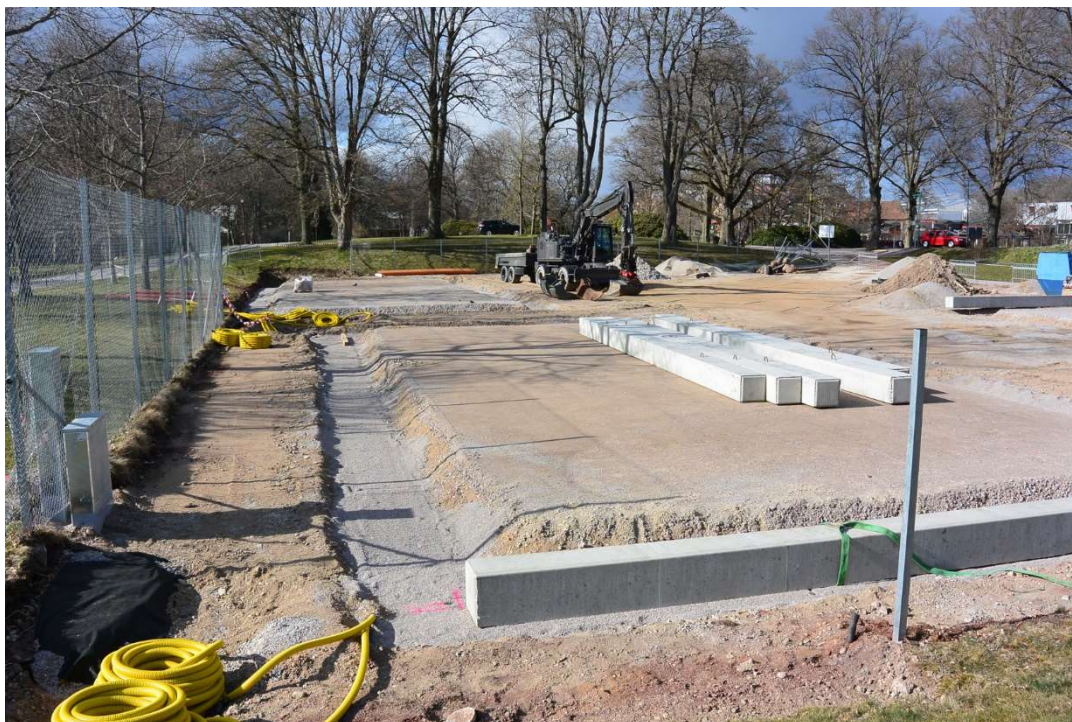
Fig. 10. Pågående schaktning och utjämning av bärlagret samt utplacering av betongbalkar kring varje padelbana. (Jfr fig. 12 och 14.)
