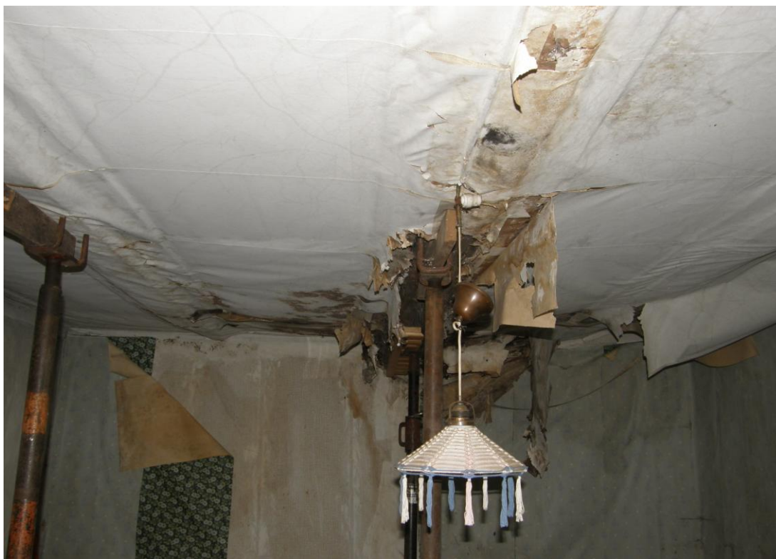
Fig. 20. Takskadan i Stugan.
