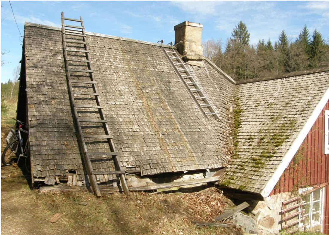
Fig. 2. Vinkeltillbyggnaden, södra takfoten svårt rötskadad.
