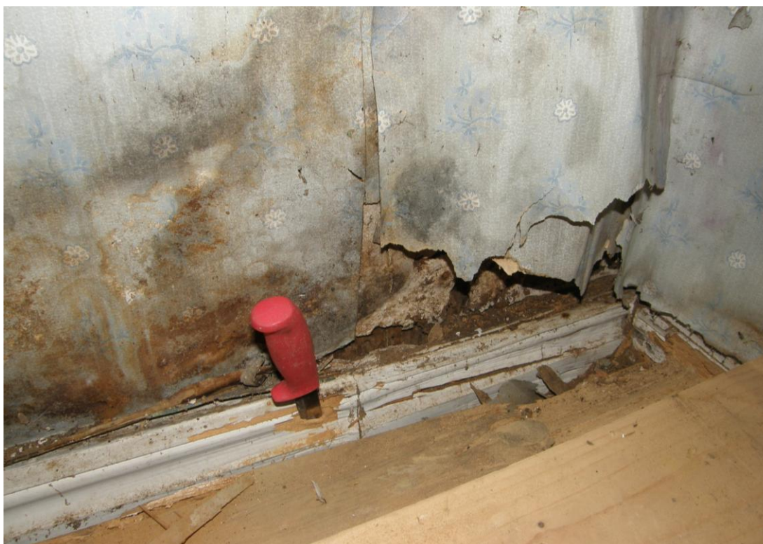
Fig. 21. Rötskadad golvlst, Stugans sydöstra hörn (sannolikt gammal skada).
