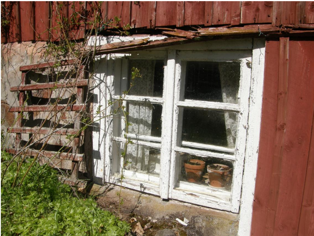
Fig. 8. Fönster 2, södra gaveln. Vattbräda förbrukad.
