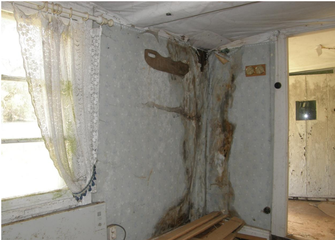
Fig. 6. Stugans sydöstra takskada.
