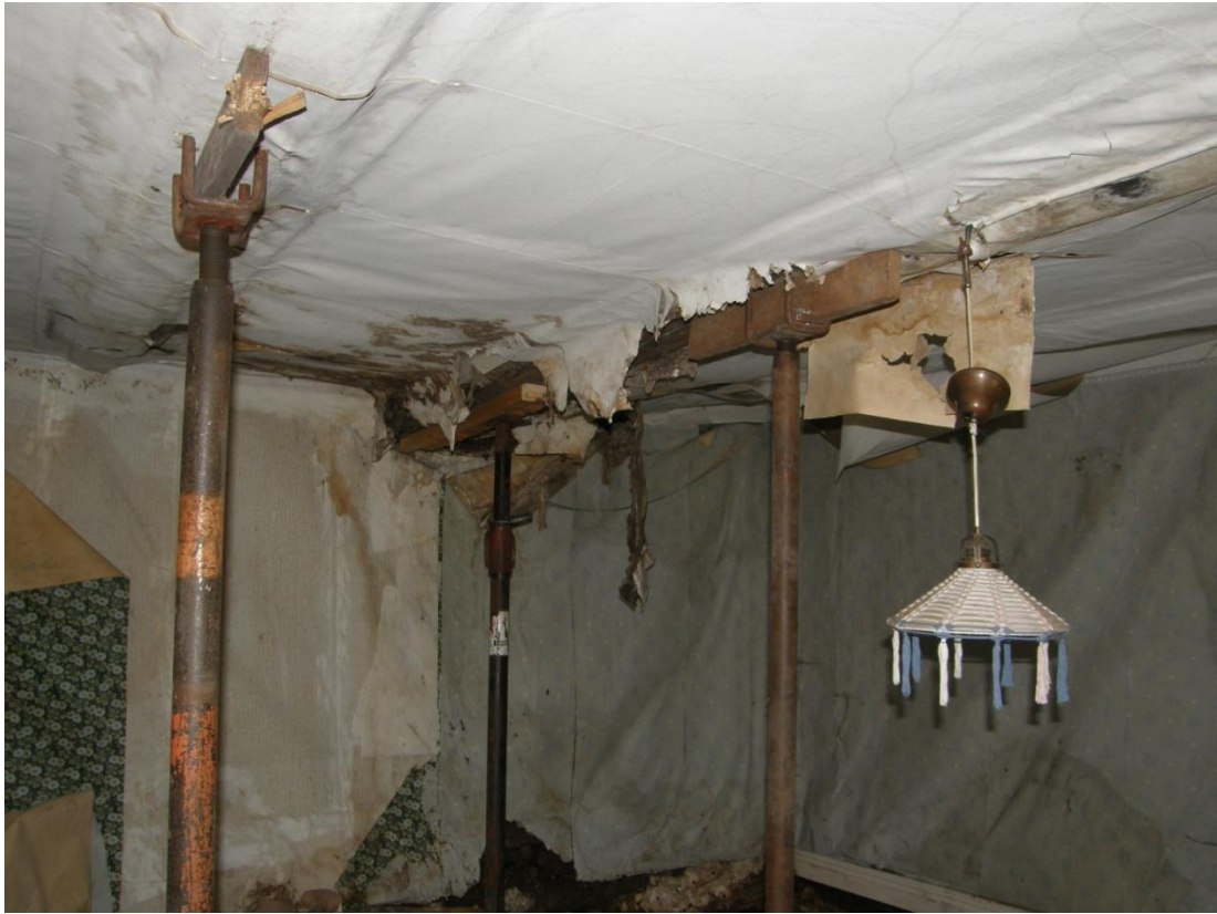
Fig. 5. Stugans västra takskada.
