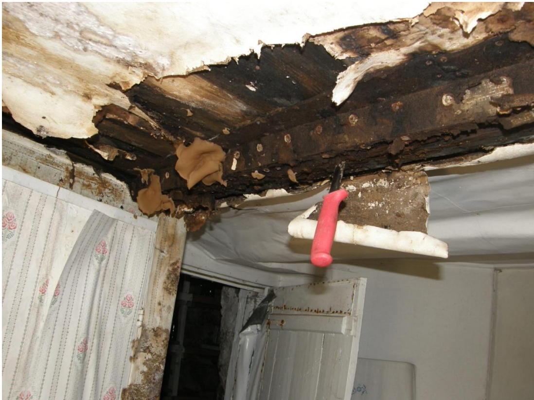
Fig. 4. Takskadorna i köket. Notera svamppåväxten! Skafferiet till vänster.
