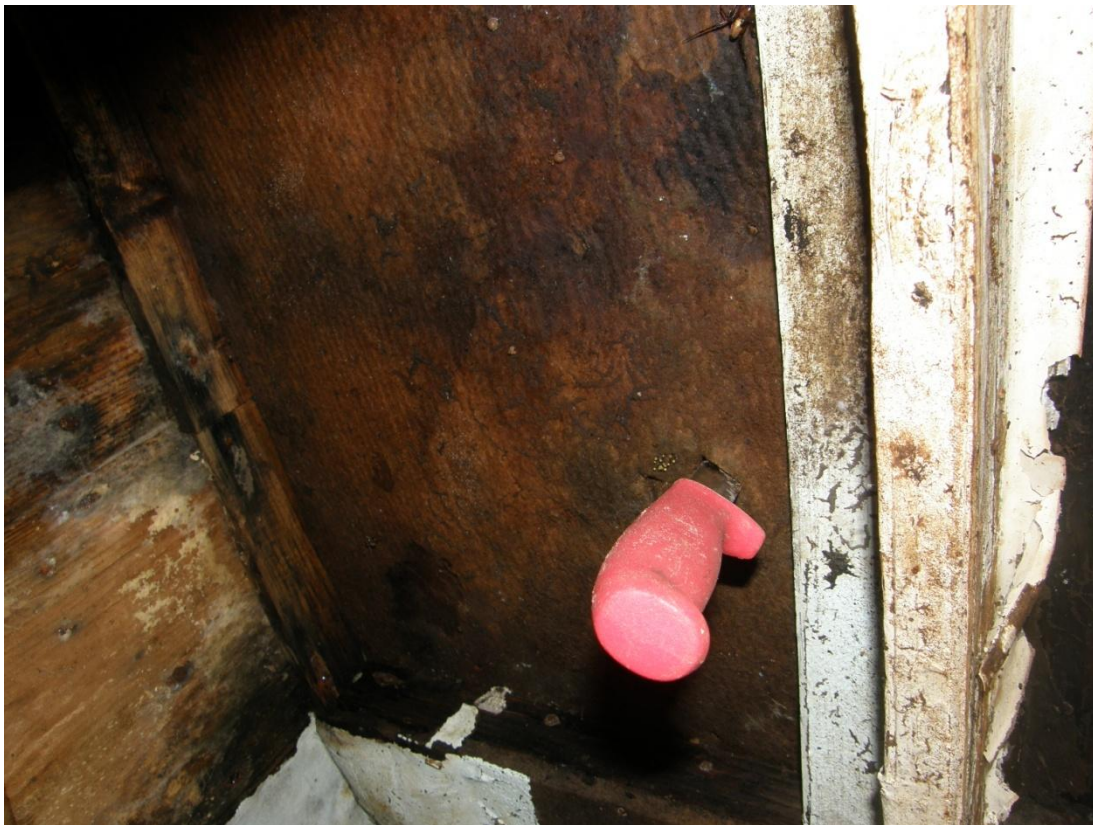
Fig. 19. Skafferiets innertak, tretex, rötskadad.
