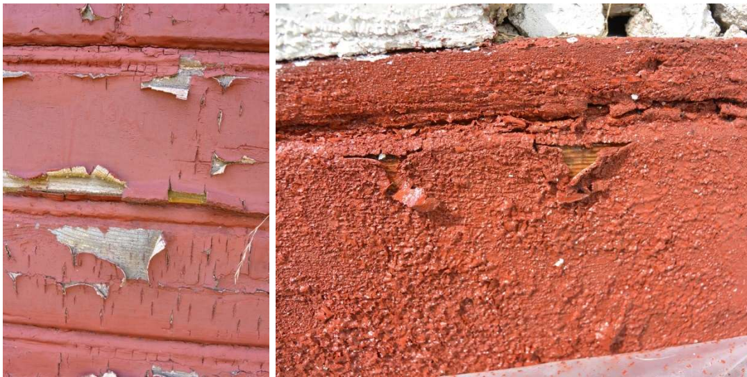
Fig. 6. Flagande och sprucken färg på panel, före arbetet. Fig. 7. Färgborttagningsmedlet har verkat, färgen luckras upp och lossnar från underlaget.
