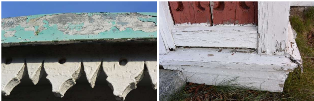
Fig. 10. Del av verandataket med dekorativ snickarglädje, före arbetet. Fig. 11. Verandans rötskadade vattbrädor..
