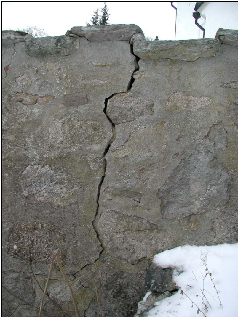
Fig.2 – Spricka i utsidan av kyrkogårdsmur öster om Jämshögs kyrka.
