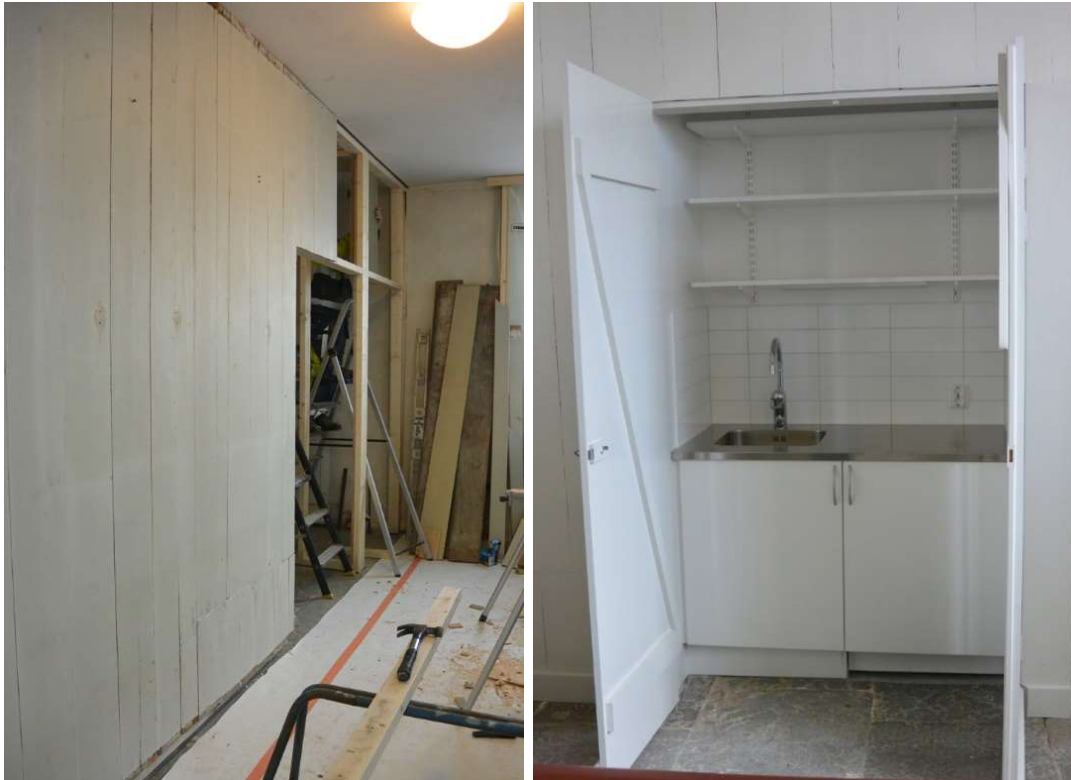
Fig. 15. Den flyttade väggen med återanvänd panel. Fig. 16. Det nya pentryt. Installationen döljs bakom bräddörrar när det inte används.
