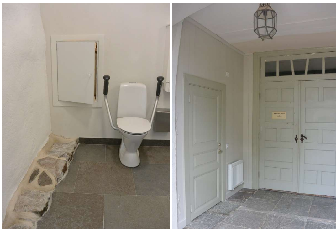
Fig. 19. RWC efter arbetet. Omputsad vägg och utskjutande stensockel till vänster, jfr fig. 13. Fig. 20. Vapenhuset efter arbetet, jfr fig. 3.
