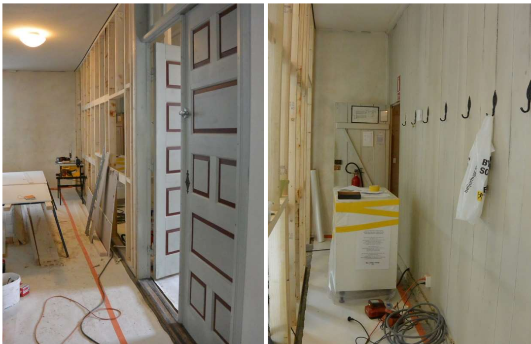
Fig. 7. Den nya regelstommen är på plats och pardörren mellan vapenbus och kyrkorum har flyttats. Fig. 8. Insidan av det nya utrymmet med den nya regelstommen till vänster och bevarad panelvägg till höger.
