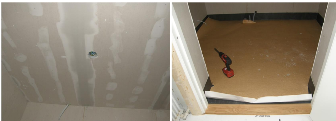
Fig. 7. Innertak och väggar är klädda med gipsskivor. Fig. 8. Vinylmattan är lagd. Den gamla dörren är utbytt mot en modern samt ny tröskel av ek är monterad. Till vänster skymtar nya fasade dörrfoder.
