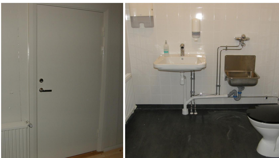
Fig. 9. Utsidan av den nya dörren är målad med linoljefärg likt vapenhusets väggar. Fig. 10. Färdigt HWC-utrymme, vägg mot väster.
