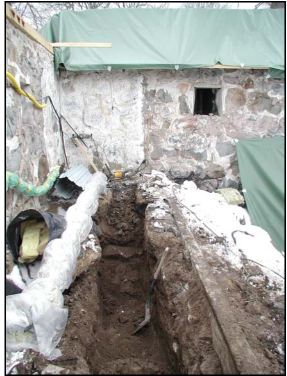
Fig.7 – Kabelschakt bredvid källaren.
