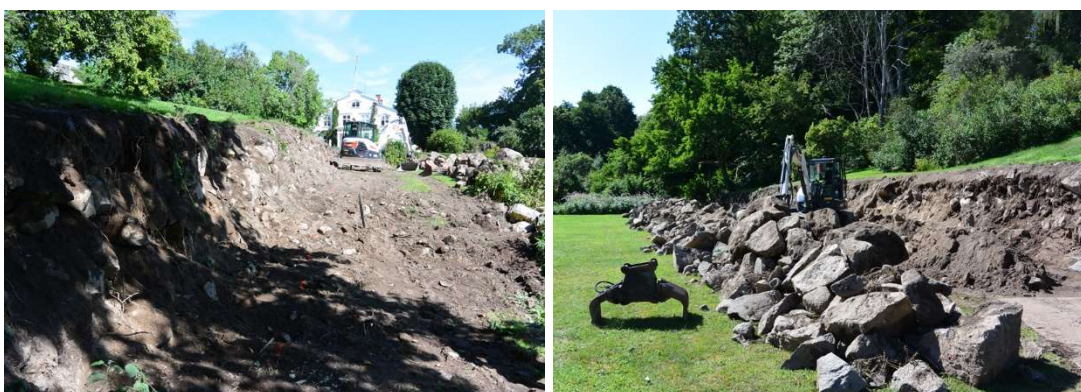
Fig. 12. Nedplockad mur, vy mot norr. Fig. 13. De nedplockade stenarna lades parallellt utmed muren.
