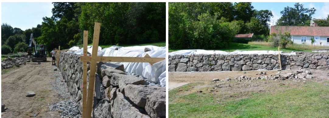
Fig. 14. Under återuppbyggnad med invändig geotextil och komplettering av dräneringsmaterial. Fig. 15. Vy mot väster.
