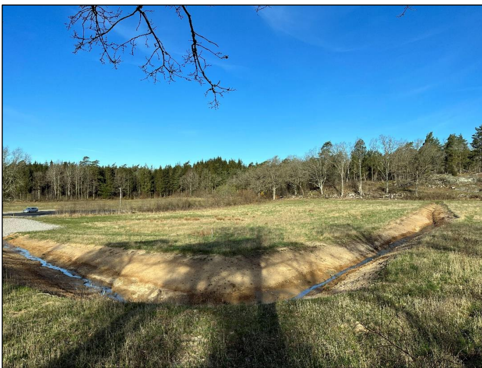
Fig.2 – Utredningsområdet fotograferat mot V. Exploatering påbörjad genom att dränerande åtgärder redan gjorts.
