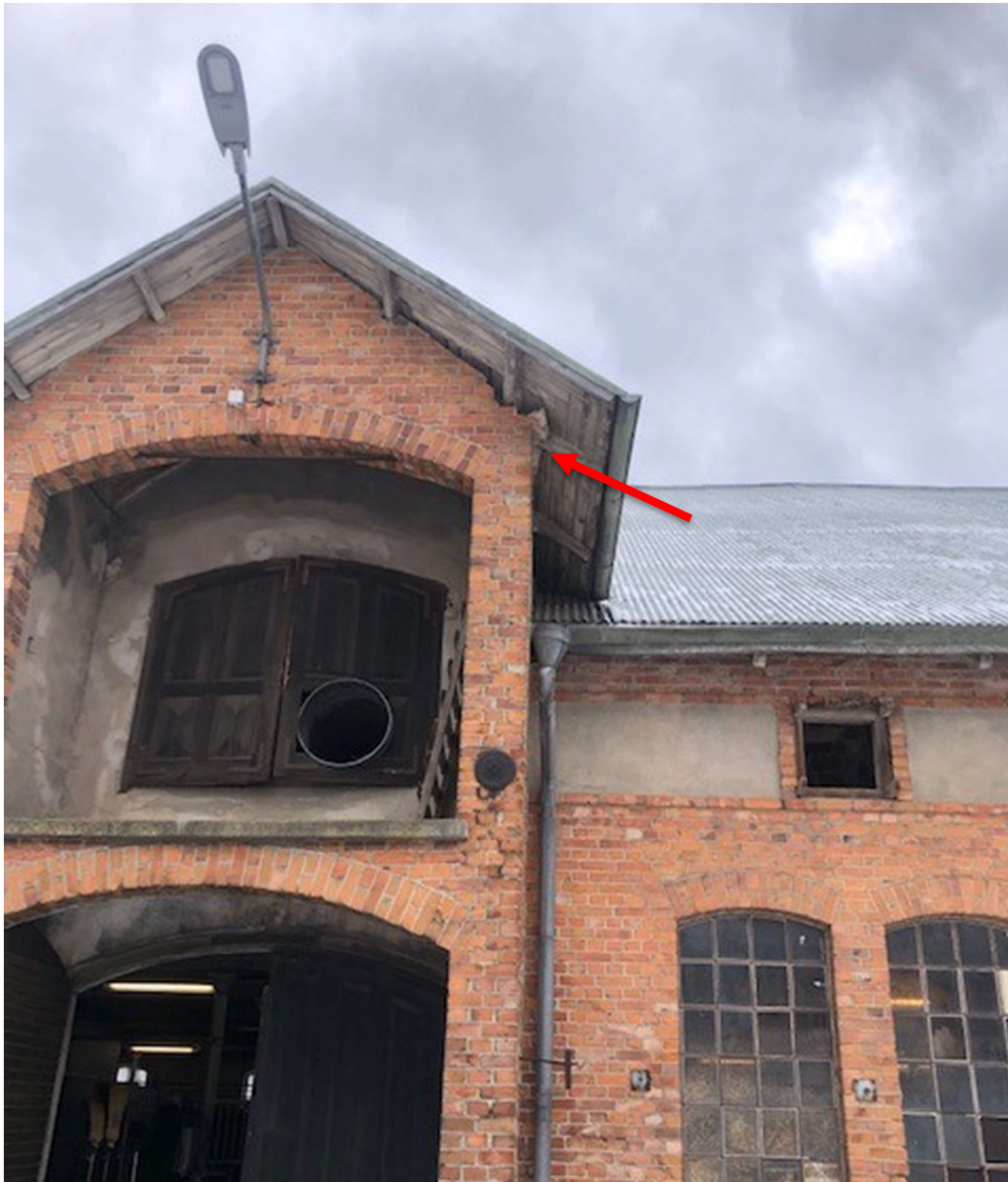
Fig. 3. Den västra huvudentrén före arbetet (foto Anders Svensson, Allt i murning ). Röd pil visar skadad del.
