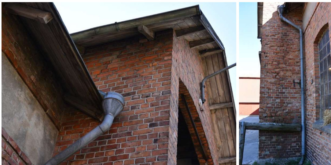
Fig. 6. Sprickbildning i övre delen av norra entréväggen. Fig. 7. Frostsprängt tegel på södra entréväggen.
