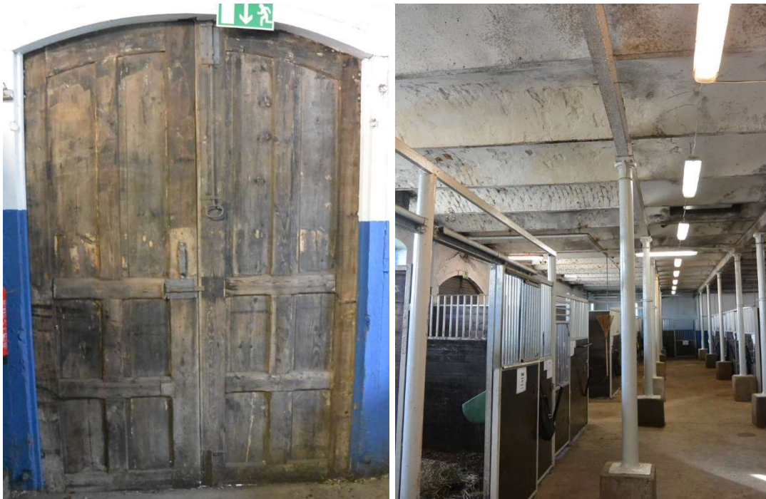
Fig. 15. Insidan av entréns välbevarade trädörr. Fig. 16. Stallens interiör med tegevalv och järnbalkar som vilar på stolpar av gjutjärn.
