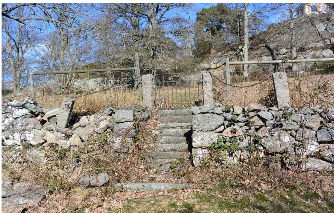
Fig. 3. Del av mursträcka 1 före renovering. Stigen genom grinden leder till lusthuset som syns i övre högra hörnet.
