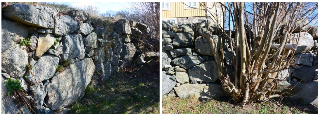
Fig. 10. Mursträcka 2, vy mot sydost, före renovering. Raserat parti skymtar till höger i bild. Fig. 11. Omfångsrik hasselbuske invid muren, jfr fig. 15.
