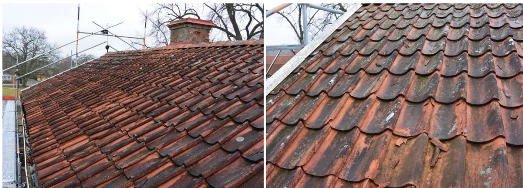
Fig. 3. Norra takfallet, vy mot öster. Fig. 4. En stor andel av pannorna på norra takfallet var spräckta och vittrade.
