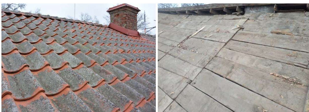
Fig. 5. Södra takfallet, vy mot öster. De befintliga takpannorna var i förbällandevis gott skick. Fig. 6. Befintligt sviktande undertak av brädor, vilket bildade en glipa längs takåsen (foto Anders Pettersson).
