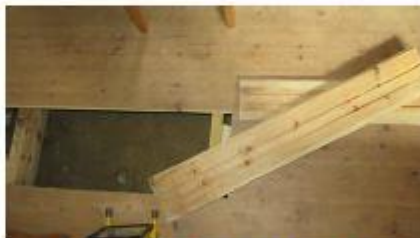
Foto 8. Det är moderat påväxt av mögelsvamp på både undersidan av golvet och på golvbjälkarna.
