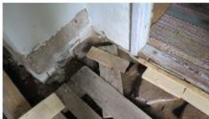
Foto 3. Golvet i hallen har en temporär uppbyggnad.
