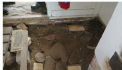
Foto 4. I nedre del av skiljevägg mot farstu har lokalt angrepp av liten hussvamp.
