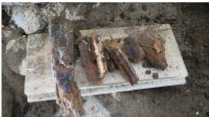
Foto 5. Röttskadat virke från nedre del av skiljevägg på foto 4.
