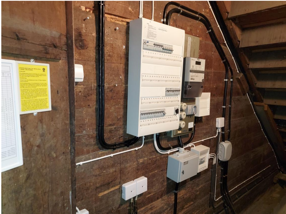
Fig. 3. Ny huvudcentral under trappan i bakre förstugan.
