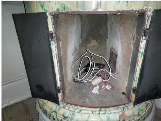
Fig. 8. Exempel på äldre kabeldragning.
