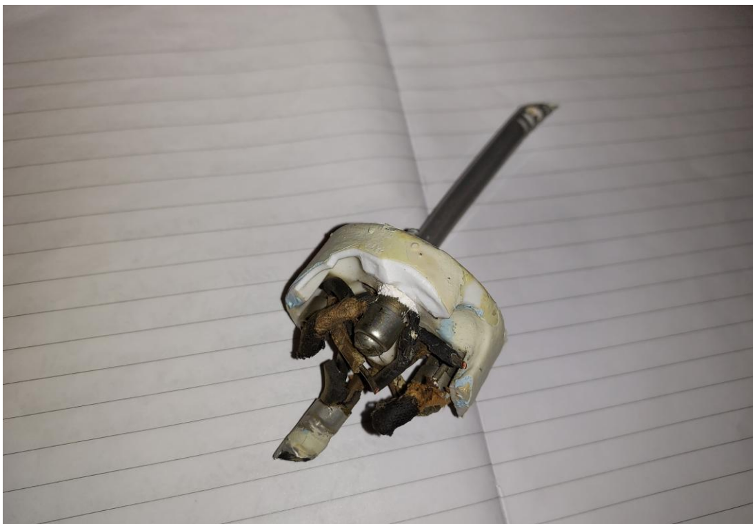
Fig. 2. Kopplingsdosa med svåra skador i kontaktorna och avklippt kuloledning, vilken var dragen genom timmervägg. Under arbetet med elsaneringen visade det sig att den avklippta ledningen fortfarande var strömförande, varför det framstår som ett under att byggnaden inte fattat eld.
