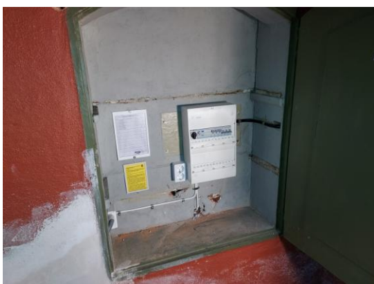
Fig. 6. Ny undercentral i källaren.
