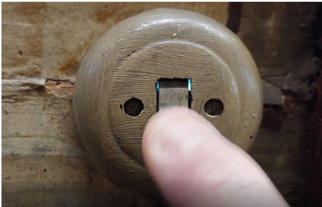
Fig. 1. Äldre strömbrytare utan bottenplatta, monterad på norra timmerväggen i främre förstugan, innan arbetet. Notera ljusbågen som syns inne i kåpan när belastning sker!
