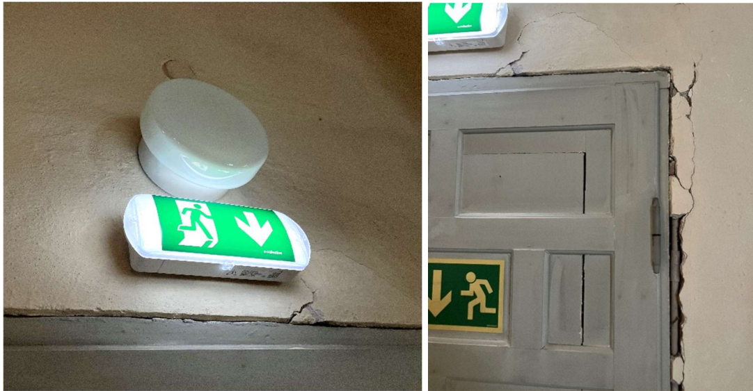
Fig. 4. Monterad nödbelysningskylt. Fig. 5. Sprickebildning i anslutning till dörröppningen.
