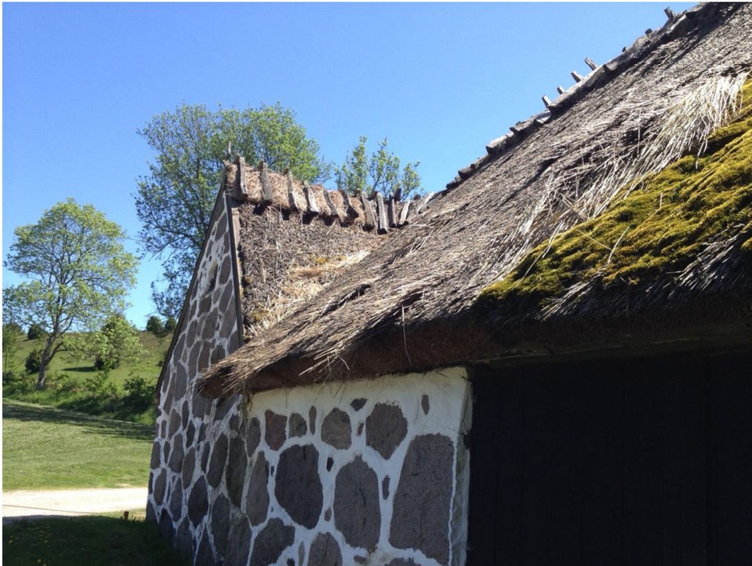
Fig. 7. Skador på norra takfallet. Foto Ingmar Melin.
