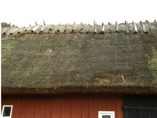
Fig. 5. Exempel på lagningar, södra takfallet.
