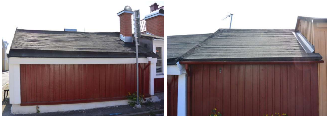
Fig. 4 och 5. Västra takfallet före arbete.
