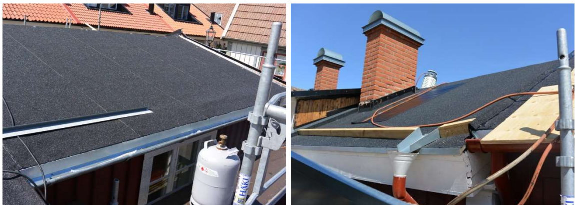
Fig. 8. Östra takfallet, ny mot norr, under arbete. Takpappen är lagd. Fig. 9. Västra takfallet. Takpappen är lagd och en ny fotränna är monterad men ännu inte pappklädd. Skorstenarnas inskottsplåtar återstår.
