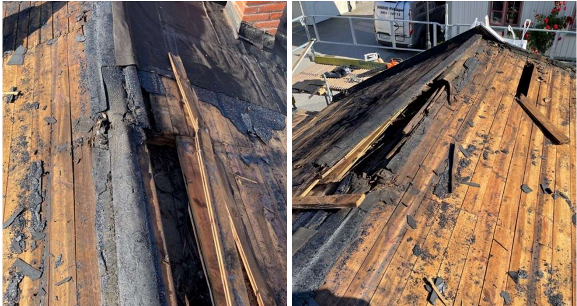
Fig. 6 och 7. Rötskadad räspont under den gamla papptäckningen på norra delen av byggnaden. (Foto Håkan Alm.)
