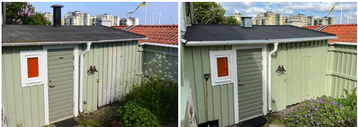
Fig. 18 och 19. Före och efter omläggning av papptak samt byte av ventilationshuv och bräddörr.
