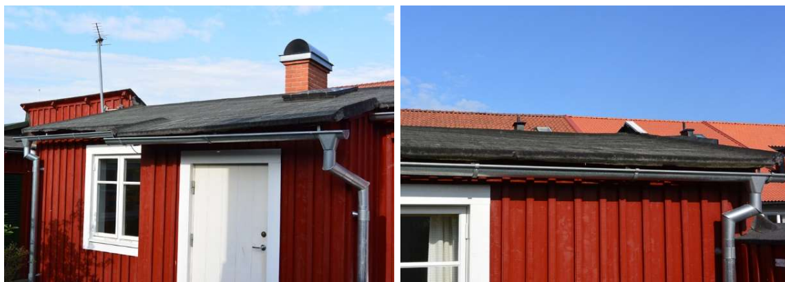
Fig. 2 och 3. Östra takfallet före arbete. Befintlig papp bedöms vara förbrukad.
