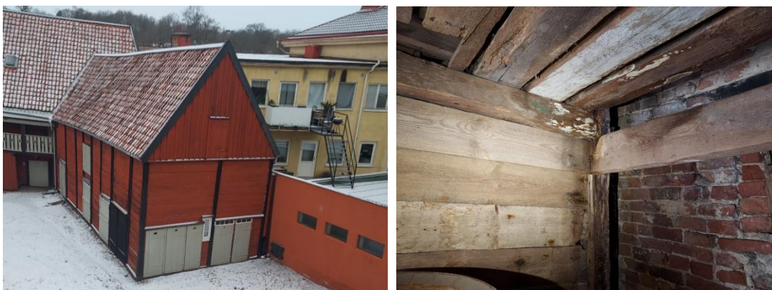
Fig. 2 (t.v.) Stallbyggnaden (bild ej tagen i samband med arbetet). Fig. 3 (t.h.). Timmerskada i norra längans stalldel, bottenvåningen.
