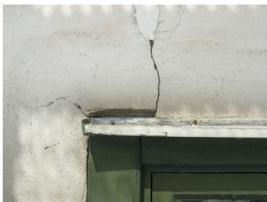
Fig. 1. Exempel på sprickskada.
