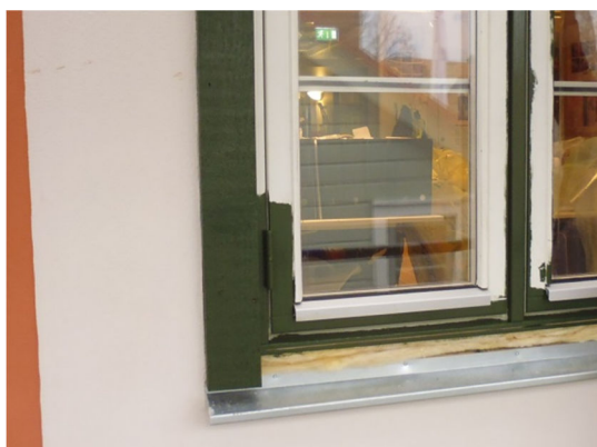
Fig. 15. Nyttillverkat, ej godkänt fönster.
