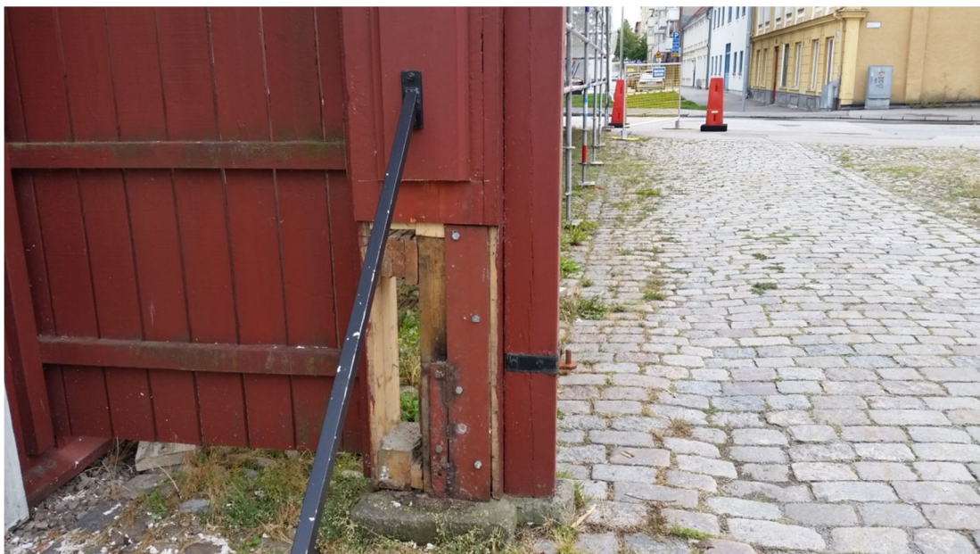
Fig.16. Befintlig stolpe vid delfinportens östra sida. Notera de olika äldre lagningarna.
