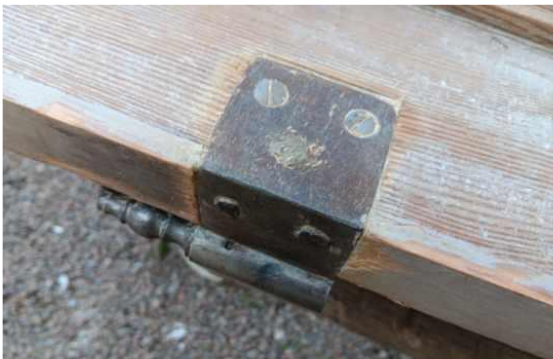
Fig. 12. Rengjort dörrblad och gångjärn.
