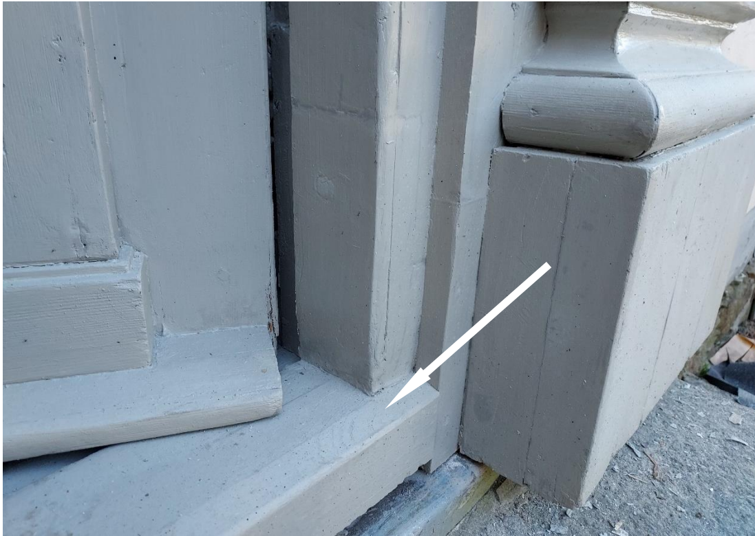
Fig. 20. Östra dörren, efter arbetet – men innan vattplåten monterats. Notera den skarvade tröskeln (vit pil).
