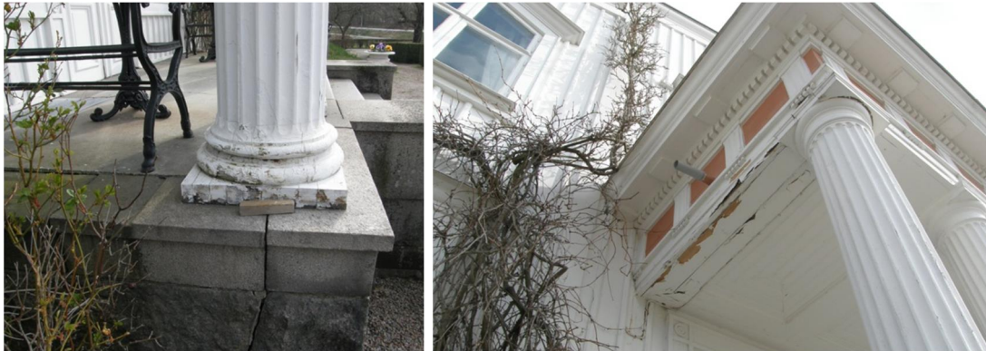
Fig. 1 (t.v.). Regnvatten har bidragit till färgflagning på balkongens kolonner. Fig. 2 (t.h.). Kraftig färgflagning på balkongens västra undersida.
